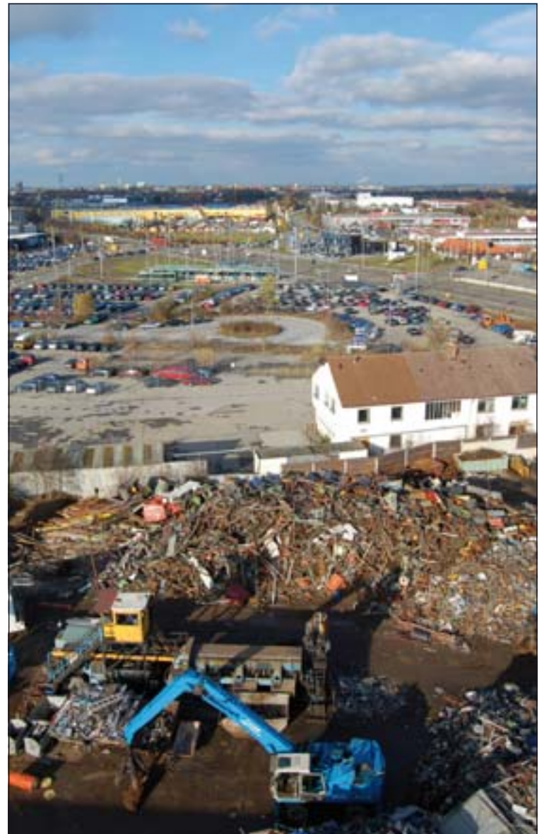
An der Grenze zu Gersthofen entsteht in Oberhausen ein neues Gewerbe- und Dienstleistungszentrum.
